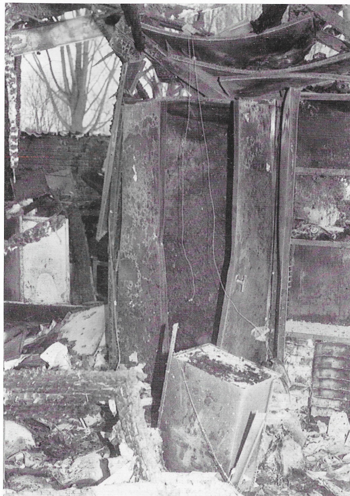
Gedeelte van de compleet uitgebrande archiefruimte.
